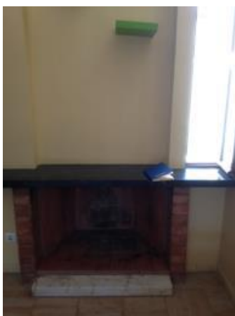
Figura 15 – Fotografia da lareira a substituir por recuperador de calor (alimentado a biomassa)
