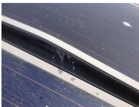
Figura 20 – Fotografia de registo de colapso no Painel Solar Térmico dos SMTCB
