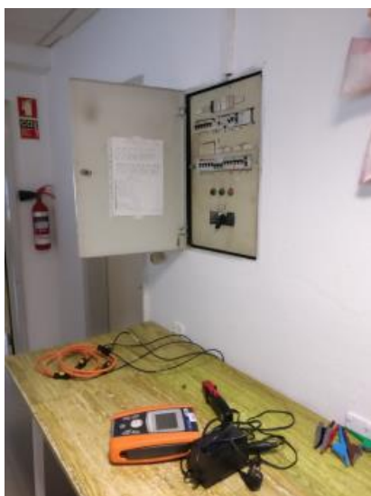
Figura 17 - Colocação de analisador de rede - Lar Abrigo do Tejo
