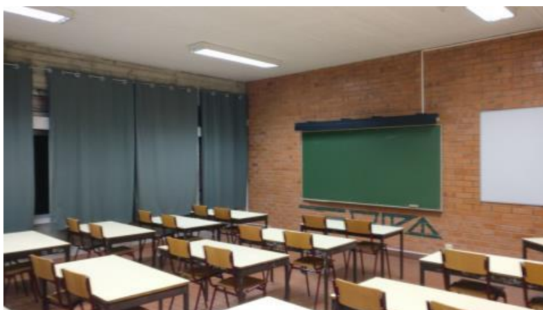
Figura 19 – Fotografia da sala de aula nº 11 após a substituição com luminárias LED
