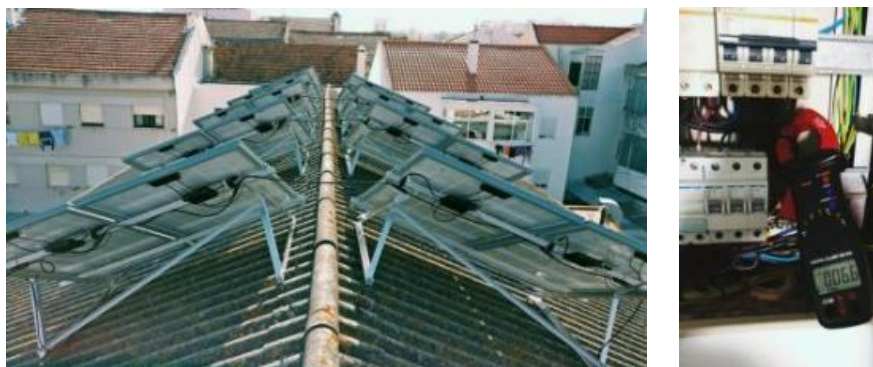
Figura 33 – Instalação solar fotovoltaica em autoconsumo implementada
