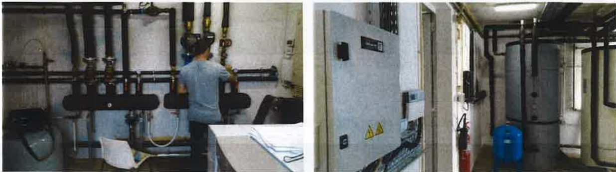
Figura 6 – Verificação de pressupostos de projeto e apoio ao comissionamento da instalação
