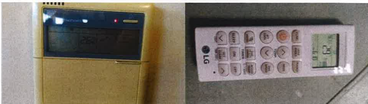
Figura 3- Temperaturas interiores desajustadas e ciclos contrários às condições térmicas exteriores, perceção errada das condições interiores pelos utilizadores e modo de operação dos sistemas.
