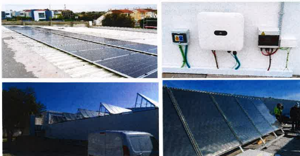
Figura 38 – Sistemas de energia solar fotovoltaica e térmica
