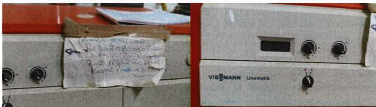
Figura 11 - Única indicação de funcionamento de uma central térmica. Caldeira ligada com instalação fechada, set-points desajustados e desconhecimento completo do conceito de funcionamento da instalação.
