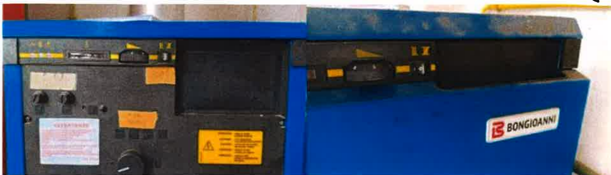
Figura 20 - Indicação de funcionamento de uma central térmica – Controlo de temperatura de AQS por regulação de temperatura de primário de caldeira
