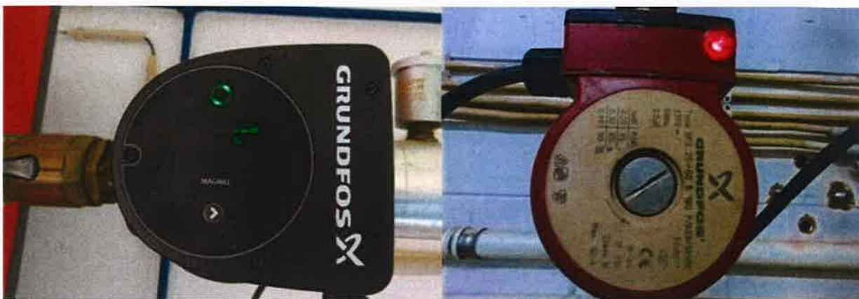
Figura 2 - Circuladores em funcionamento com instalações fechadas e set-points alcançados
