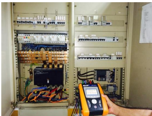
Figura 9 - Foto quadro elétrico Paços do Concelho Moita
