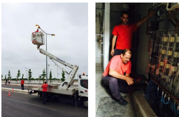
Figura 13 – Acompanhamento das medições nos PT's e nos circuitos no Município da Moita
